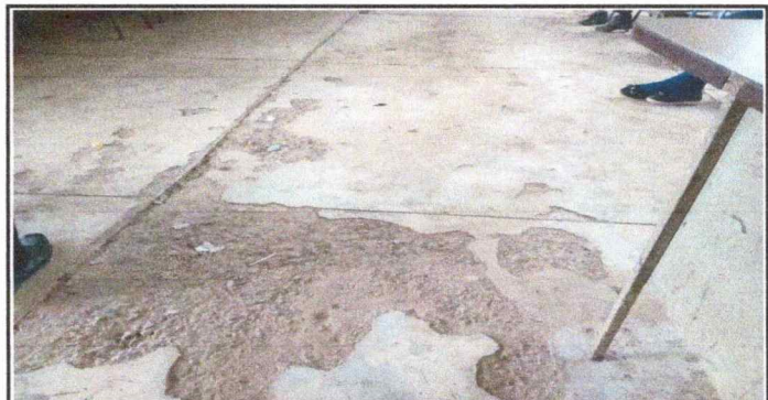
Foto 6: Se observa lo dañado que se encuentra el piso de referida escuela
