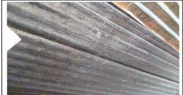
Foto 4: Se observa que se encuentra en estado avanzado de deterioridad, cambio de entechado
