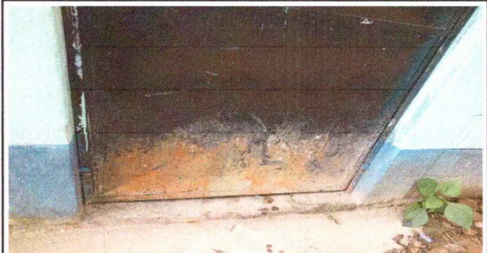
Foto 3: Se muestra el mal estado en que se encuentran dichas puertas
