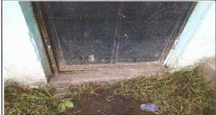
Foto 2: Se evidencia que las puertas ya están en mal estado
