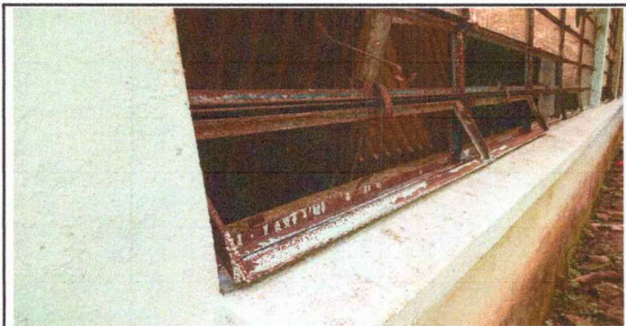
Foto 5: Se observa que las persianas de los vidrios se encuentran en muy mal estado
